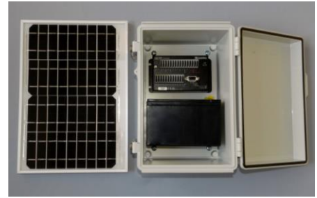
写真は太陽電池電源仕様
